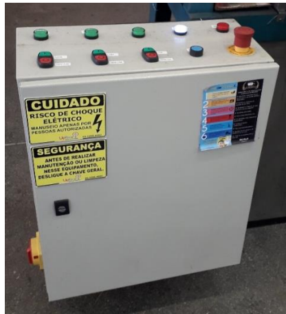
Figura 12: Quadro elétrico de comando sinalizado
