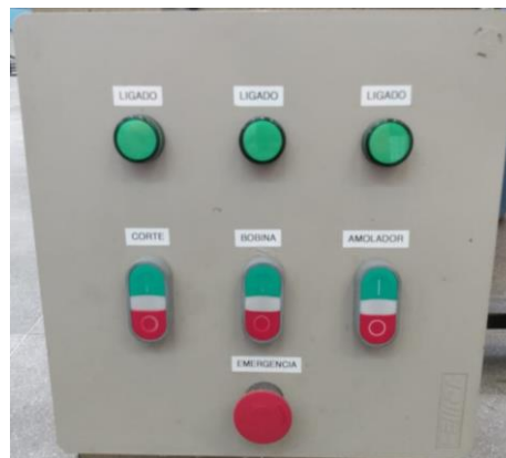
Figura 7: Quadro elétrico de comando
